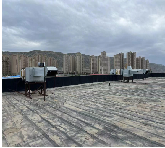
废气处理设施
