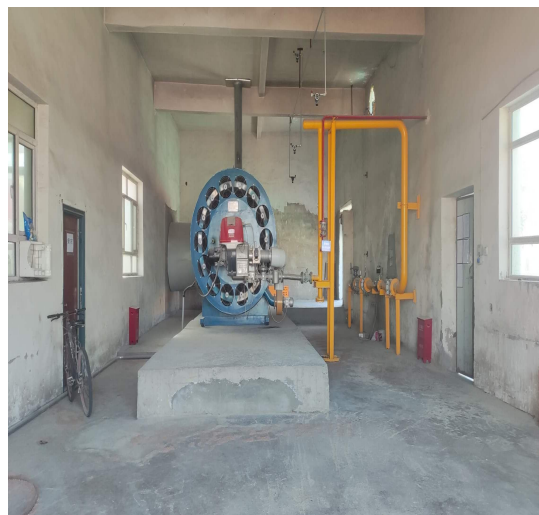
燃气热风锅炉
